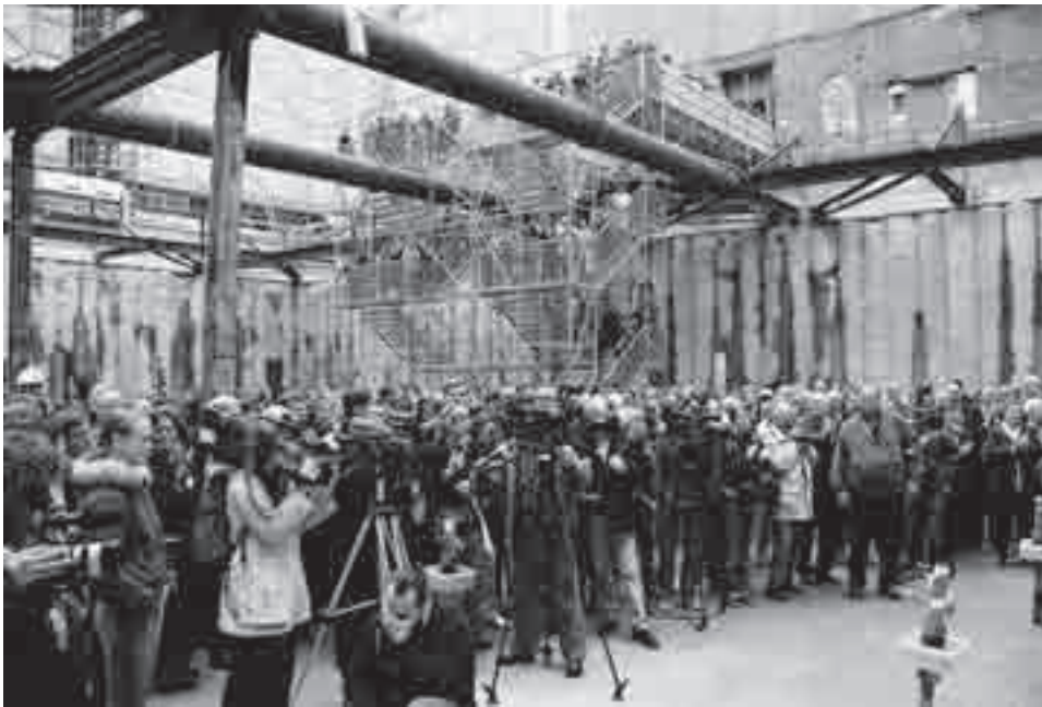
Die Gäste der Grundsteinlegung gelangten über Bautreppen in die acht Meter tiefe Baugrube. (Foto: Staatsbibliothek)
