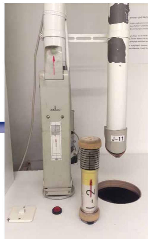
Rohrpost-Station I-11 im Gruppenarbeitsraum
